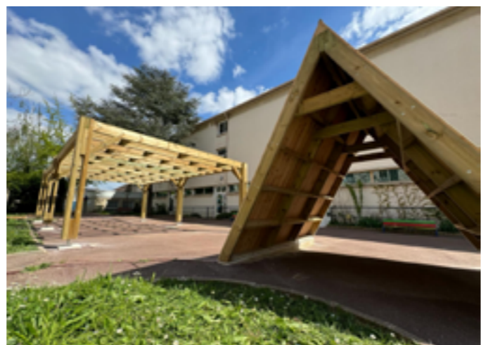
Début de la création des îlots de fraîcheur à l'école maternelle La Fontaine. Ces ensembles seront végétalisés prochainement.
